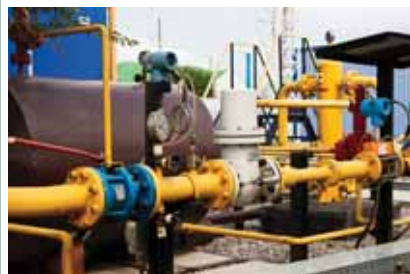
Блок входных кранов
