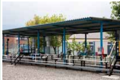
Бункеры с аккумуляторами газа
