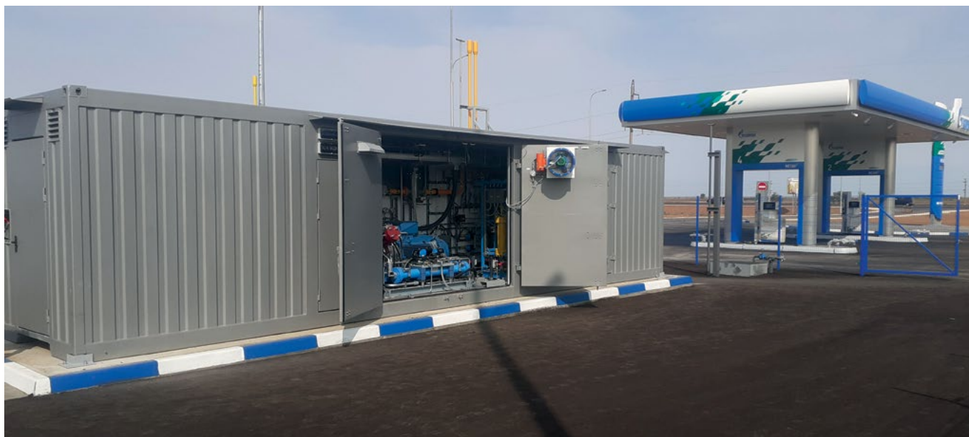
Поставка оборудования АГНКС, г. Волгоград, 2020 г.
